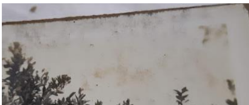
Imagen 1: Fotografía con marcas de hongos por humedad
