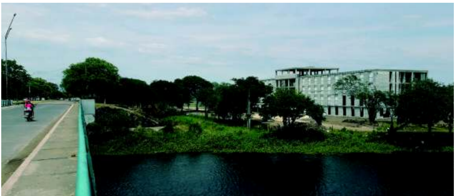
Construcción Hotel Howard Johnson en acceso al barrio La Ribera, sobre la principal vía de ingreso a Resistencia
