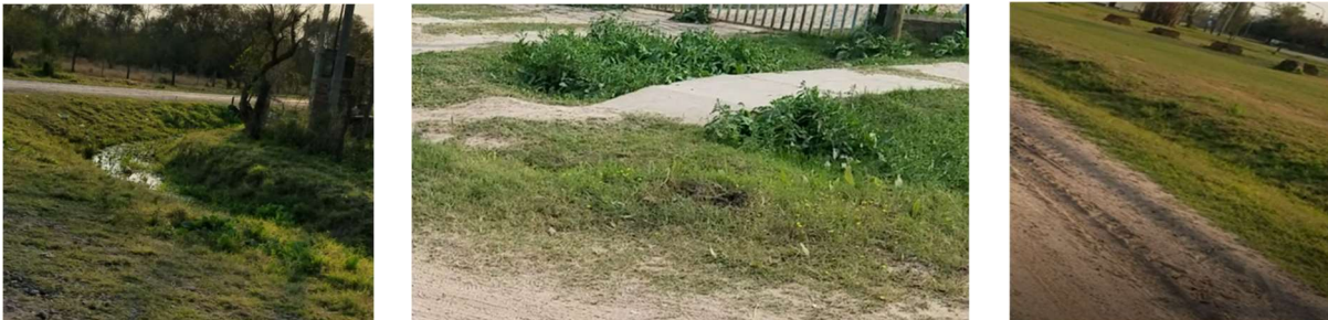
Figura 4, 5 y 6: Estado actual de las cunetas.
