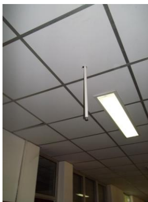
Antena de media longitud de onda para WI-FI. Campus universitario
