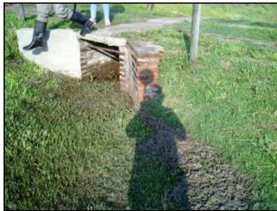
Figura 2.2. Estado de alcantarilla sobre ruta de acceso principal – Margen izquierdo. Acceso vehicular.
