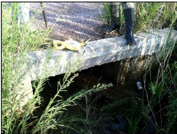
Figura 2.1. Estado de alcantarilla sobre ruta de acceso principal - Margen derecho. Acceso vehicular.
