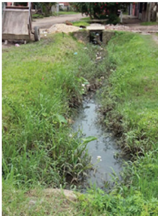
Figura n°5: cuneta obstruida. Fuente: material propio.
