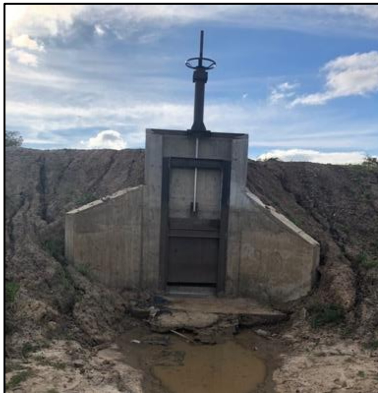
Figura 6.21 Foto de una alcantarilla con compuerta deslizante tipo guillotina (Fuente: elaboración propia).
