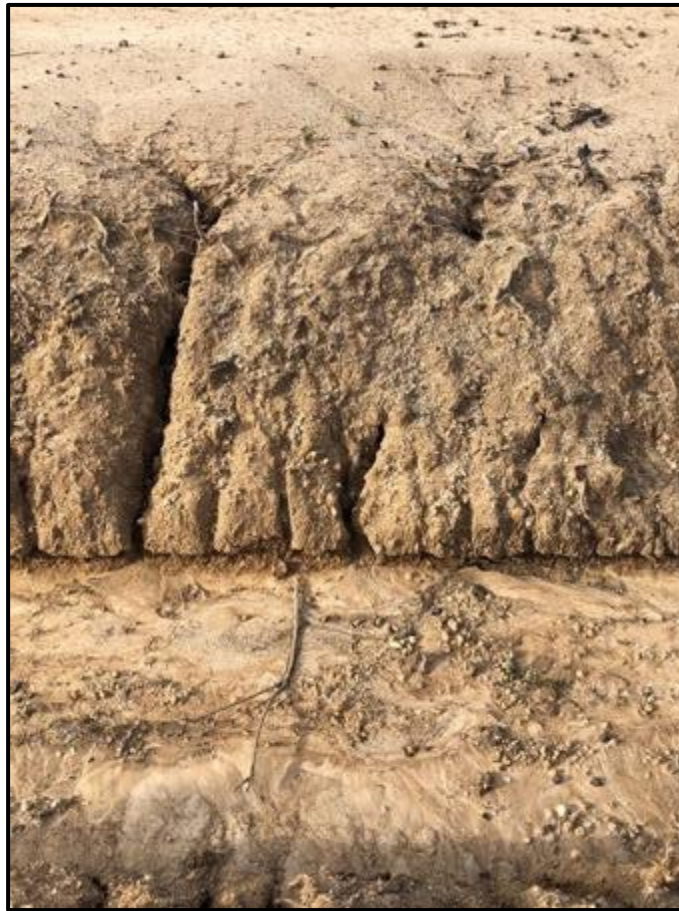
Figura 6.4. Erosión en la base y el talud de un canal existente en la ciudad (Fuente: elaboración propia).
