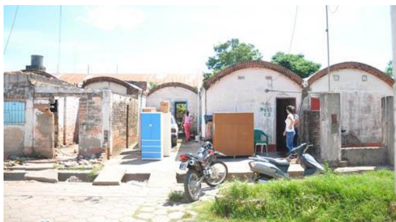
Foto N°48: Traslado de los habitantes y demolición de viviendas del barrio toba. Fuente: Diario digital ESCHACO.
