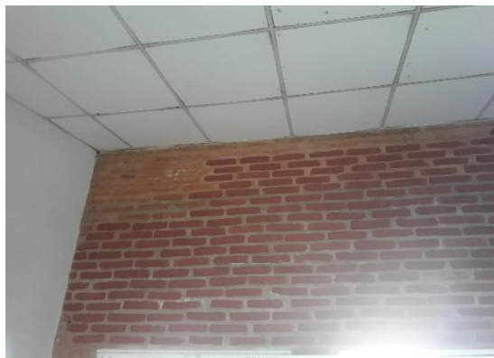
Foto N°12: Filtraciones por déficit constructivos Fuente: Producción Propia
