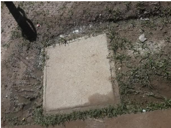
Foto N°74: Desbordes de los desagües cloacales Fuente: Producción propia
