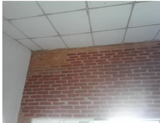
Foto N°75: Humedades producto de filtraciones de los techos Fuente: Producción propia
