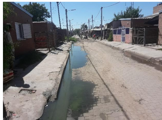
N°79: Desbordes de la red de cloacas Fuente: Producción propia
