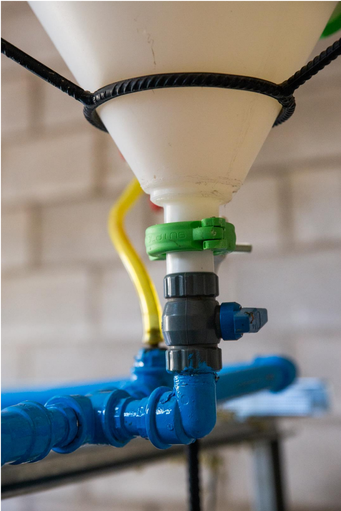
Fig. 50- Detalle de conexiones del sistema de riego con líquidos.
