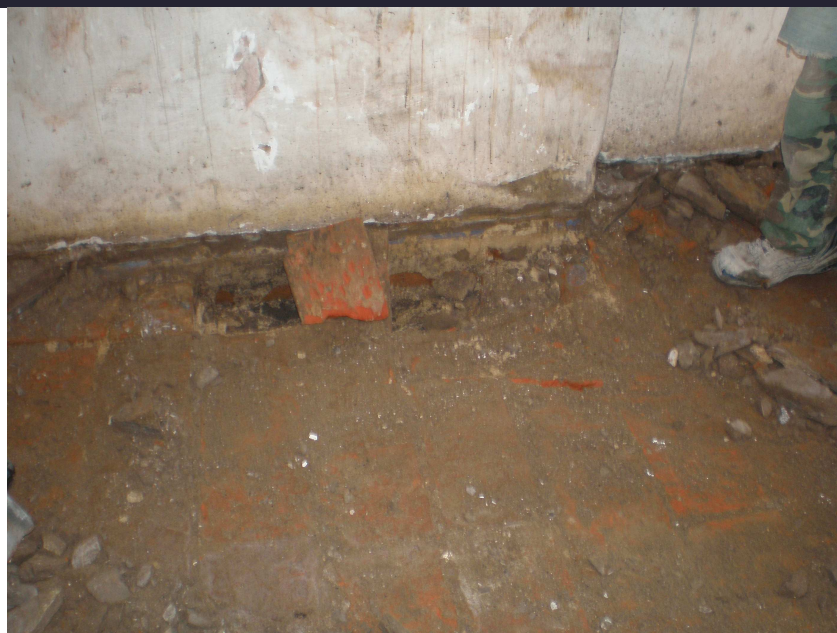
Figura 6- Sector zaguán con retiro de piso calcáreo y vestigio de piso de ladrillos
